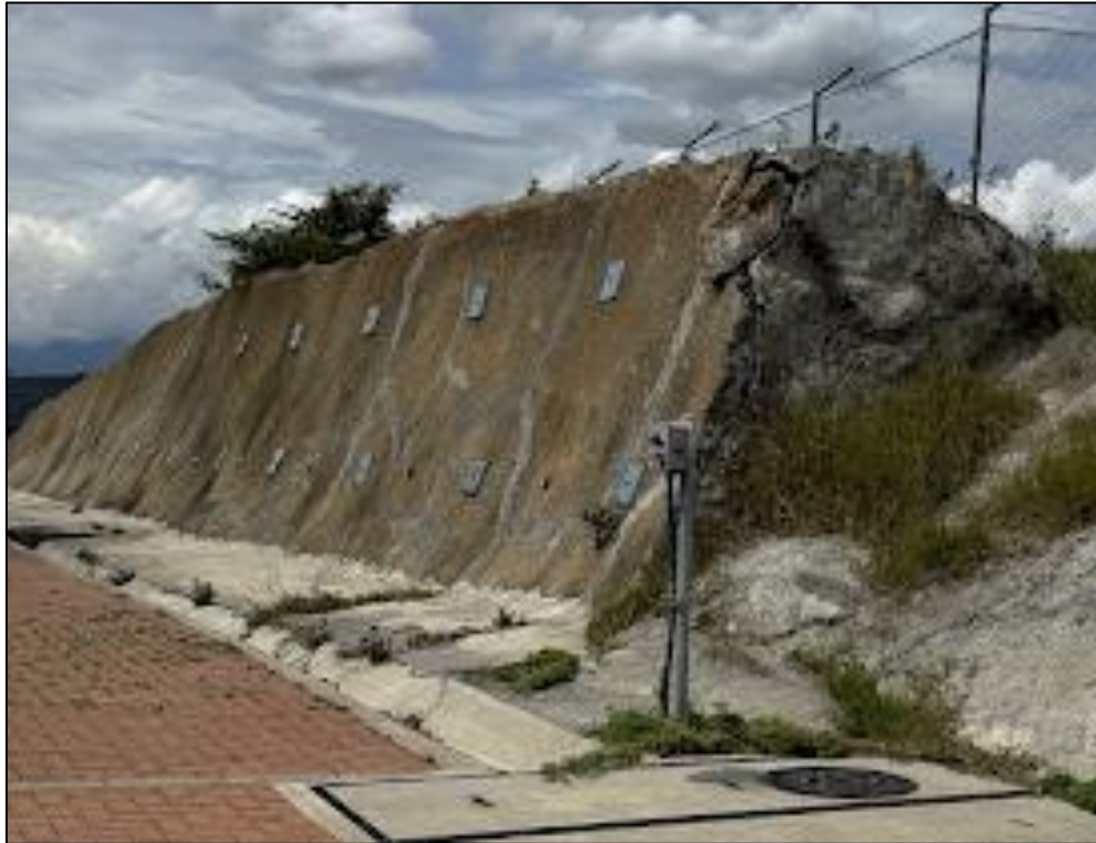
Imagen No. 2. Estructura de protección de taludes en el predio de los tanques construidos en el cerro cumbre bajas en el municipio de Los Patios. Se observan que dicha estructura en medio del proceso constructivo fue objeto de labores correctivas, además de señalar la ocurrencia de fenómenos de cedencia y fisuras en dicha estructura
