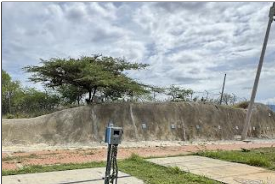
Imagen No. 1. Estructura de protección de taludes en el predio de los tanques construidos en el cerro cumbre bajas en el municipio de Los Patios. Se observan que dicha estructura en medio del proceso constructivo fue objeto de labores correctivas, además de señalar la ocurrencia de fenómenos de cedencia y fisuras en dicha estructura
