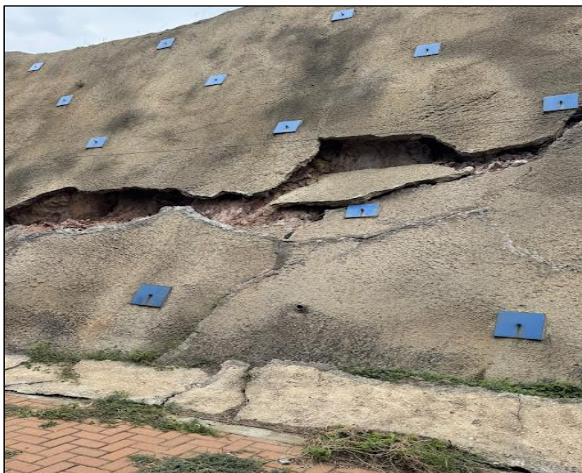
Imagen No. 3. Se observa deterioro y pérdida de funcionalidad de la estructura de protección de taludes en el predio de los tanques construidos en el cerro primero de mayo en el municipio de Villa del Rosario – Norte de Santander. Subproyecto 4.
