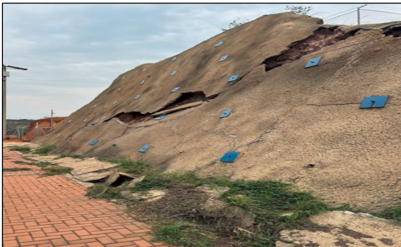
Imagen No. 1. Se observa deterioro y pérdida de funcionalidad de la estructura de protección de taludes en el predio de los tanques construidos en el cerro primero de mayo en el municipio de Villa del Rosario – Norte de Santander. Subproyecto 4.
