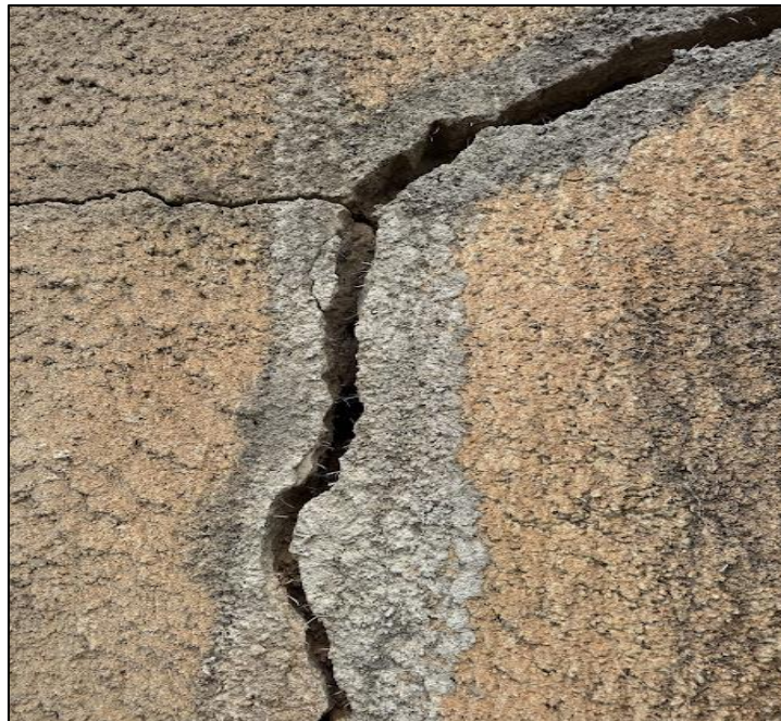
Imagen No. 4. Se observa deterioro y pérdida de funcionalidad de la estructura de protección de taludes en el predio de los tanques construidos en el cerro primero de mayo en el municipio de Villa del Rosario – Norte de Santander. Subproyecto 4.
